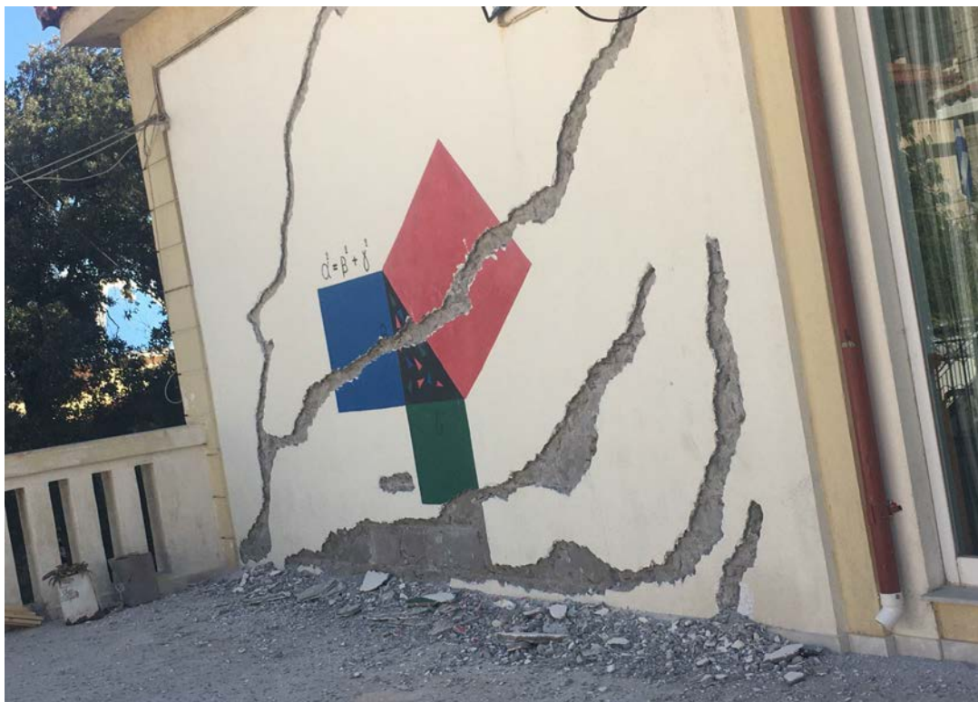
Φωτό 1: Ρηγματώσεις – αποκολλήσεις σοβάδων
