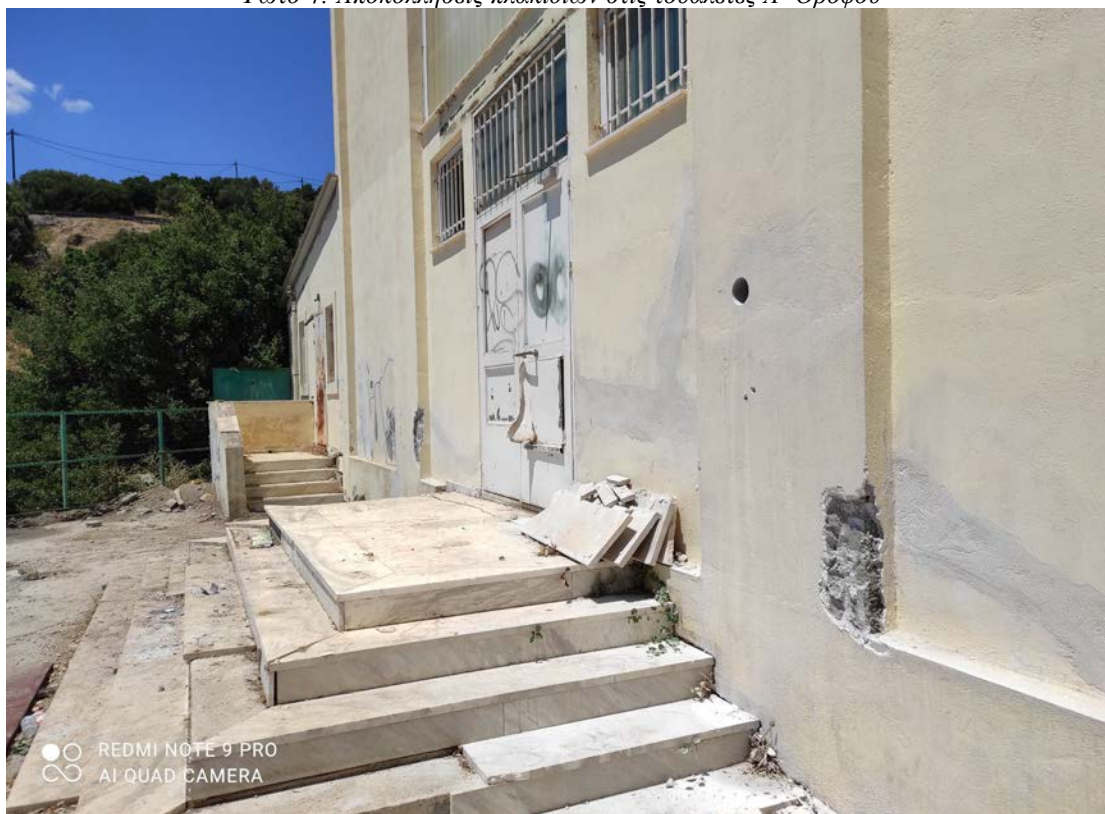
Φωτό 5: Καθίζηση αναβαθμών – εκτίναξη μαρμάρινων πλακών λόγω μερικής καθίζησης
