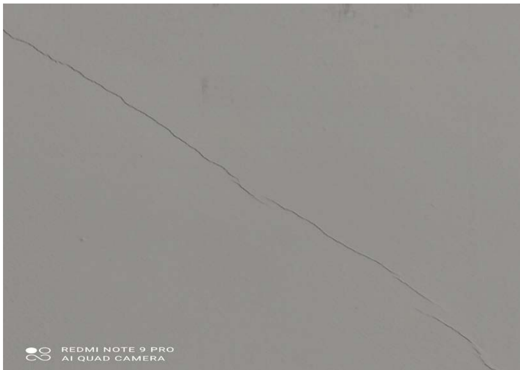
Φωτό 3: Διαγώνια ρωγμή σε τοίχο πλήρωσης Α' Ορόφου
