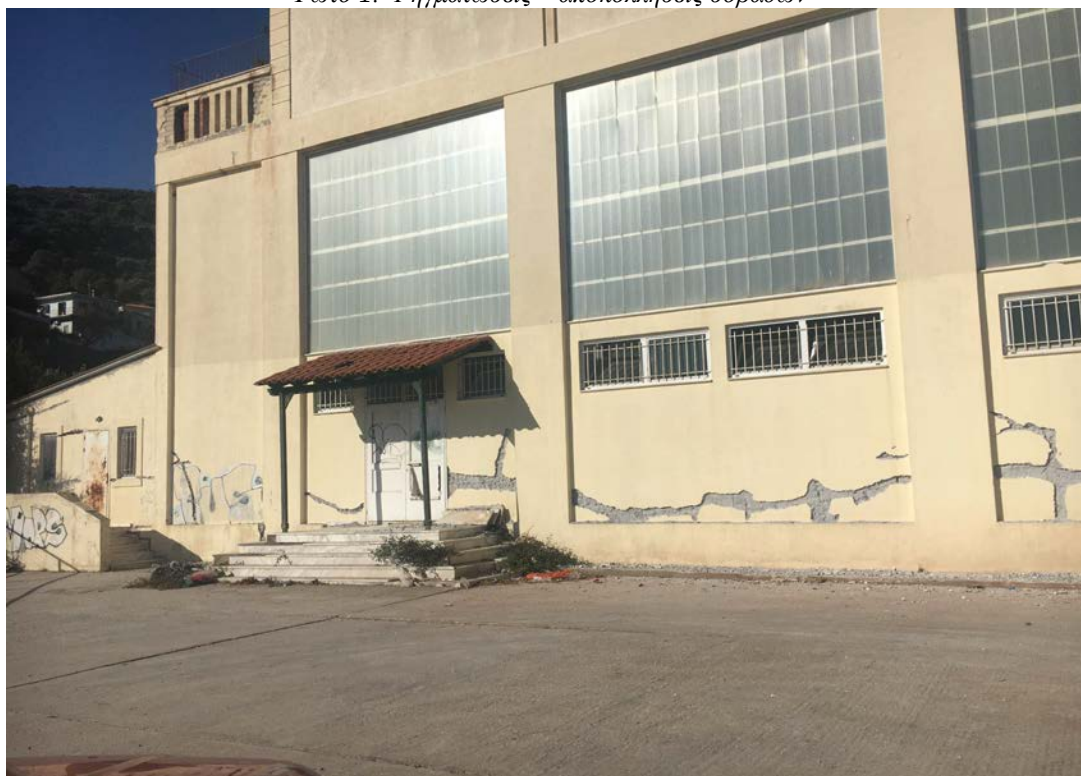
Φωτό 2: Ρηγματώσεις – αποκολλήσεις σοβάδων
